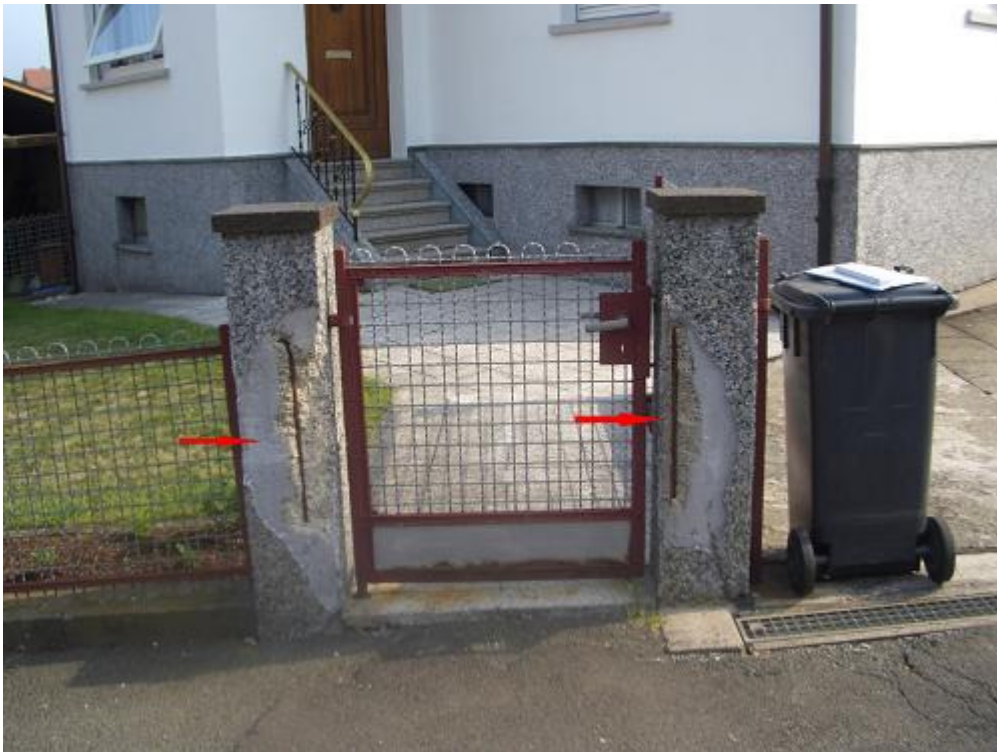
Bild 1: Abplatzungen des Betons sowie des Unter- und Oberputzes der Eingangspfeiler
