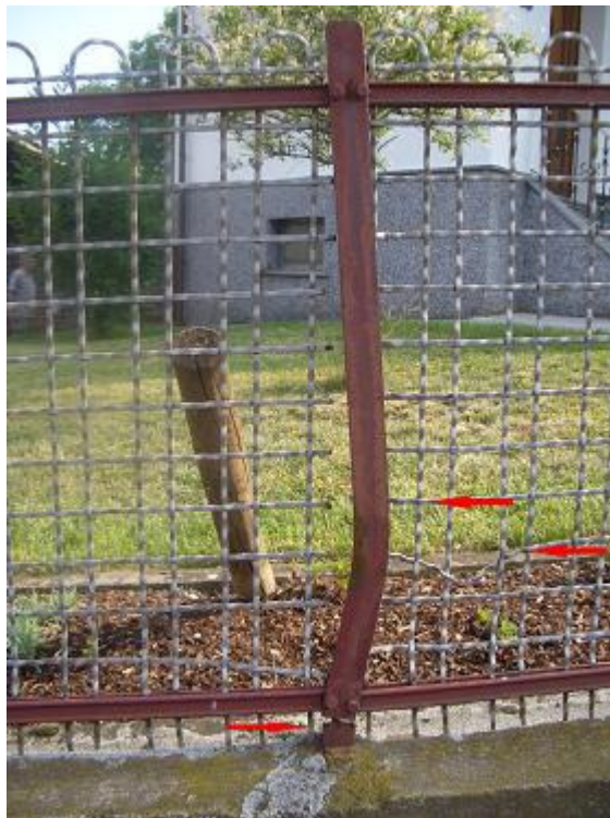
Bild 2: Pfosten des Zaunes deformiert und herausgebrochen
