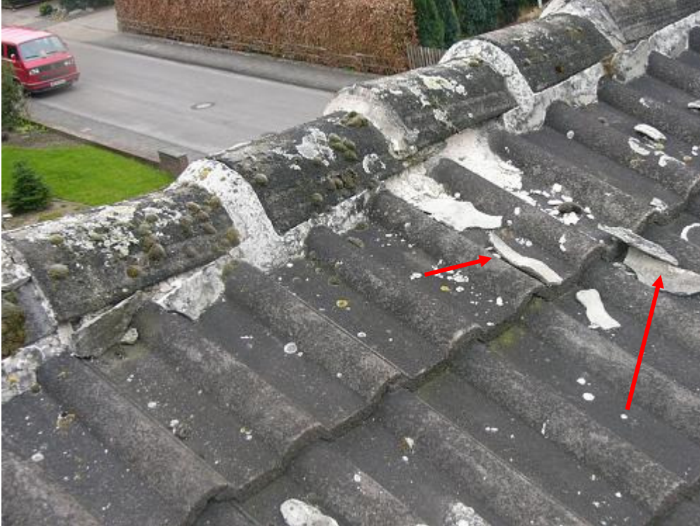
Bild 2: Frost führt zum Abplatzen des Mörtels
