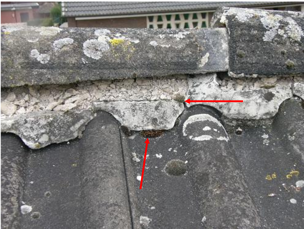
Bild 3: Aus den Fugen wächst bereits Moos
