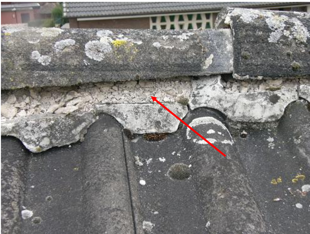
Bild 1: Der Mörtel ist stark versandet
